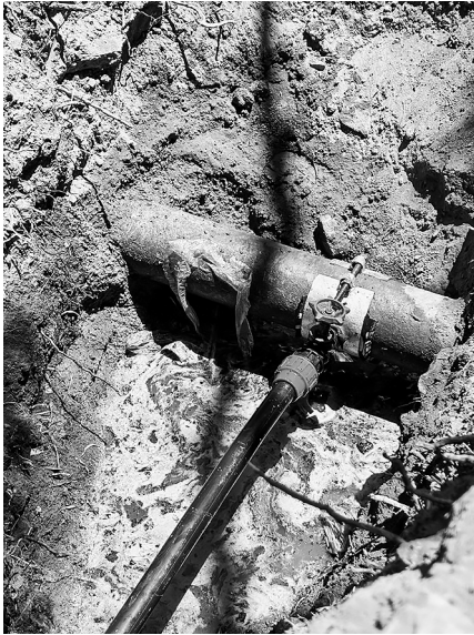
写真3 新しく接合された管の様子 管の下のほうに漏れた水が溜まっている様子が見てとれる。
