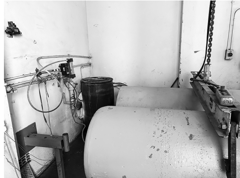
写真2 塩素注入のための設備
